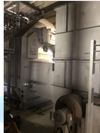
ボイラ・燃焼室
