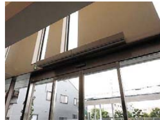
出入口のエアカーテン
