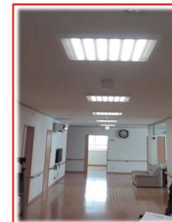
※ 器具合計=124灯、人感・照度センサー使用 ※ 消費電力計=4,449.2w
