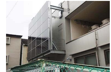
壁面設置設置太陽光発電
