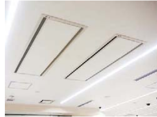
全熱交換器と高効率空調(ライン吹き出し)
