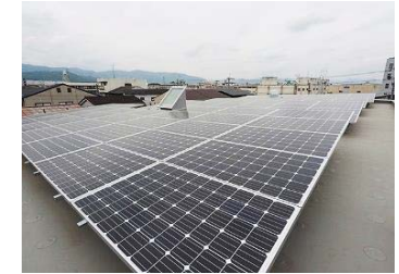
屋上設置太陽光発電
