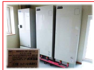
空気熱源ヒートポンプ暖房機
