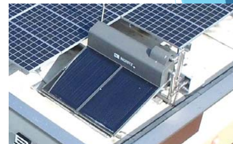
屋上設置 太陽熱利用温水器
