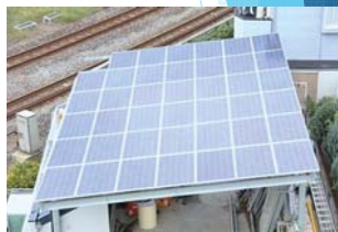
敷地内設置発電設備(10kW)
