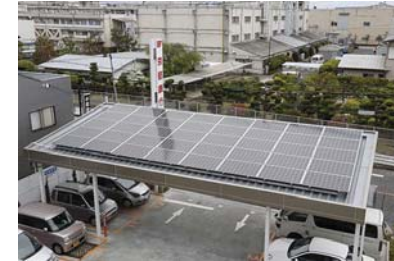
入口キャノピー設置太陽光発電
